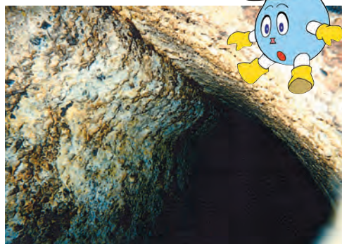
酸でぼろぼろになったコンクリート管 (下水道管：直径2m)
